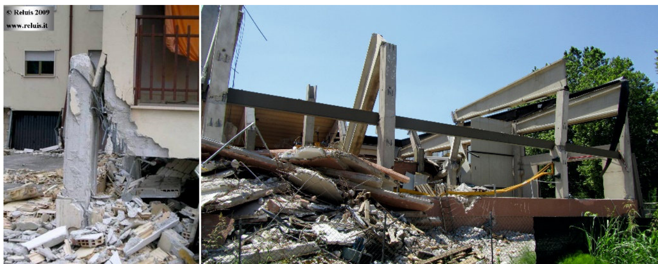
2. Esempio di piano sofficie in un edificio residenziale in cemento armato nel terremoto di L'Aquila del 2009 (sinistra) [12]. Esempio di collasso di un edificio industriale nella sequenza sismica emiliana del 2012 (destra) [13].
