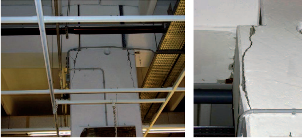
Fig. 5 Rottura localizzata della sella di appoggio della trave.
