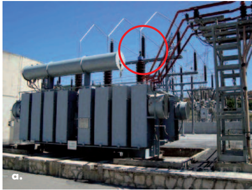
Fig. 5 (a) Danno alla connessione rigida in cima a un trasformatore. (b) Tipico danno ad una scatola di connessione.
