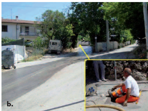
Fig. 2 (a) Condotta di Paganica dove si è verificata lo sfilamento di un giunto. (b) Riparazione di una condotta in ghisa a Paganica al momento del rientro nelle abitazioni di alcuni sfollati.
