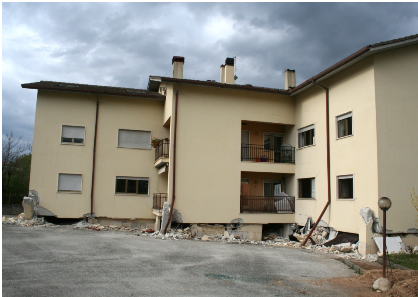
Figure 7.19. Soft storey mechanism examples in L'Aquila: Via Dante Alighieri (Pettino).
